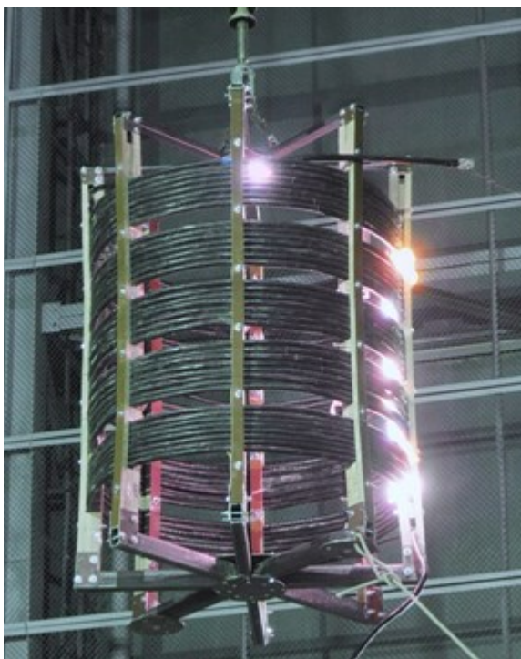
Рисунок 1.14 – Фото ЧЗУ в высоковольтном зале СибНИИЭ
