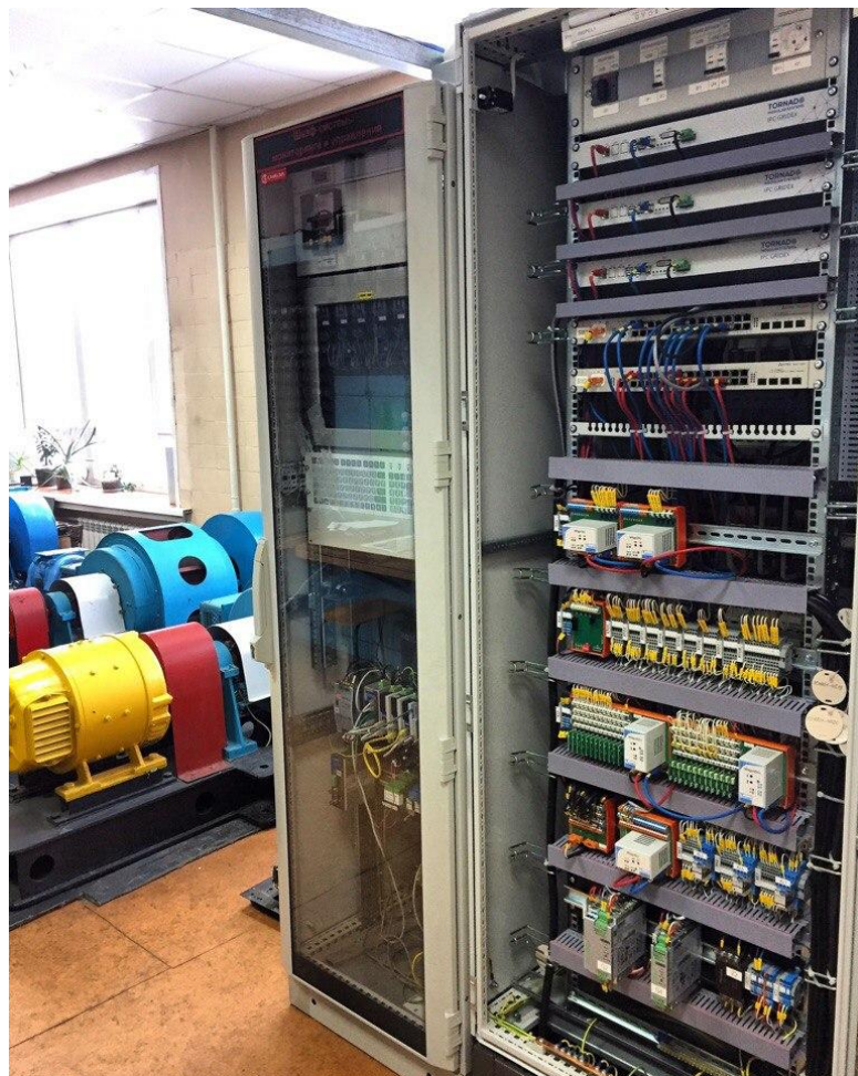
Рисунок 3.1 - Общий вид стойки автоматики
