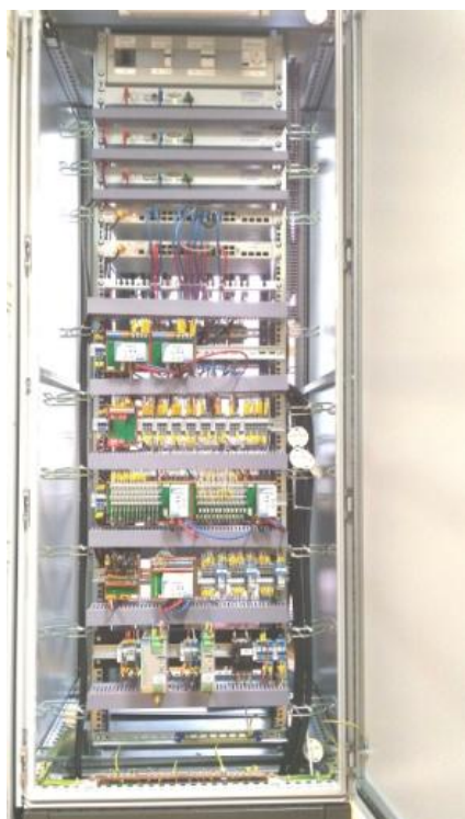
Рисунок 4.1 – Общий вид автоматики
