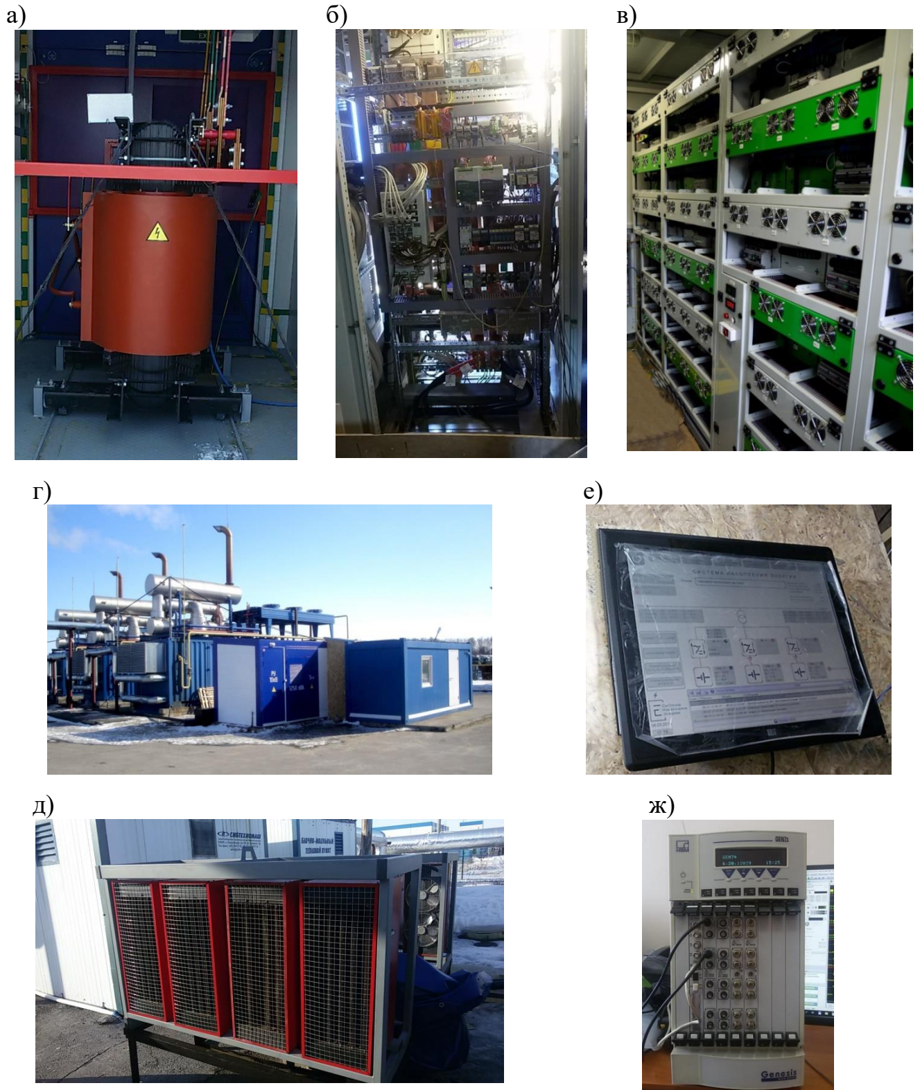
Рисунок 5.12 – Испытательная экспериментальная установка СНЭ 1200 кВА: а) силовой трансформатор; б) один из шкафов преобразовательного блока; в) аккумуляторная батарея; в) дизель-генераторная установка; г) общий вид испытательной площадки; д) один из блоков нагрузки; е) пульт контроля и управления СНЭ; ж) система регистрации данных
